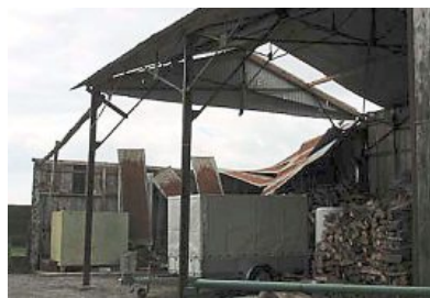
Le hangar a subi des dégâts importants.
